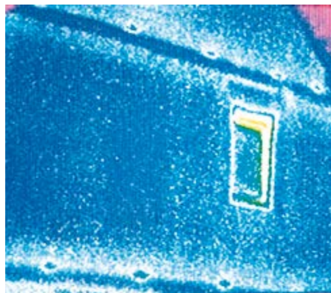
Fig. 10: Termografia del ponte termico nella zona di appoggio del solaio.
