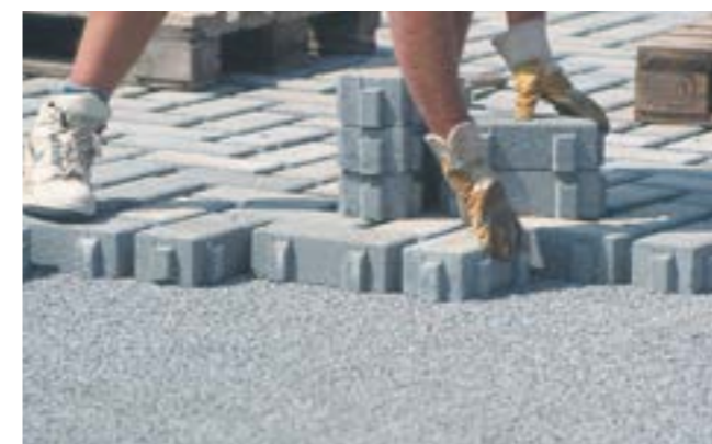
Fig. 48: Posa allineata di una pavimentazione autobloccante con giunzioni in erba per un parcheggio sulla palestra della scuola.
