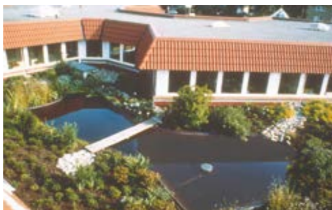
Fig. 24: Tetto a terrazza rinverdito e calpestabile con irrigazione a raccolta in stagni artificiali su una struttura di tetto rovescio con strato drenante di ghiaia su tutta la superficie.
