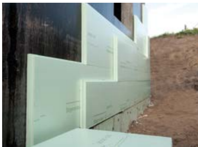
Fig. 3: Realizzazione di un isolamento perimetrale a due strati di Styrodur® fino a riempimento dello scavo di fondazione.
