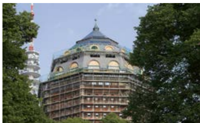
Fig. 1: Progetto di riferimento: Styrodur® viene utilizzato come isolante nel tetto dell'acquedotto di Amburgo, nell'ambito delle misure di risanamento.
